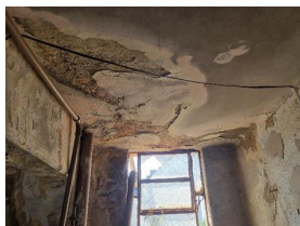
FIGURA 21 - Infiltração generalizada nos apartamentos abaixo do terraço | Fonte: Dados produzidos pelo autor (2021)
