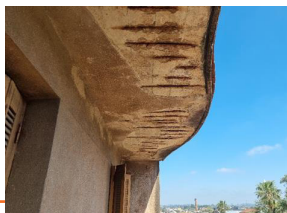
FIGURA 24 - Oxidação e deslocamento das armaduras nas lajes em balanço | Fonte: Dados produzidos pelo autor (2021)
