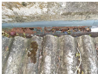
FIGURA 8 - Calha sem manutenção | Fonte: Dados produzidos pelo autor (2021)
