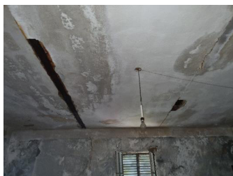
FIGURA 10 - Laje com infiltração, trilho enferrujado | Fonte: Dados produzidos pelo autor (2021)
