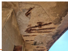
FIGURA 25 - Correção inadequada, continuação de oxidação e deslocamento | Fonte: Dados produzidos pelo autor (2021)
