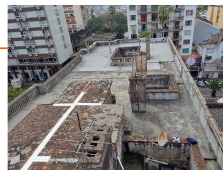
FIGURA 15 - Terraço do edifício sem manutenção. | Fonte: Dados produzidos pelo autor (2021)
