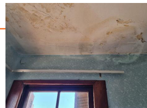
FIGURA 23 - Desgaste da pintura interna | Fonte: Dados produzidos pelo autor (2021)
