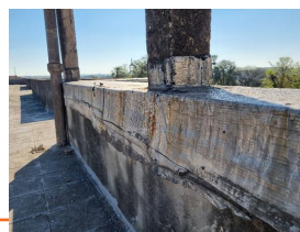
FIGURA 20 - Manta asfáltica desgastada na platibanda | Fonte: Dados produzidos pelo autor (2021)
