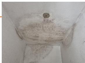
FIGURA 22 - Bolor e umidade nos apartamentos abaixo do terraço | Fonte: Dados produzidos pelo autor (2021)
