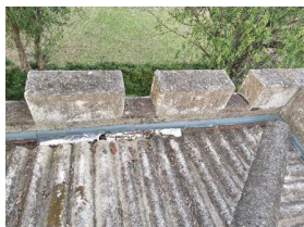
FIGURA 7 - Calha com manta asfáltica | Fonte: Dados produzidos pelo autor (2021)
