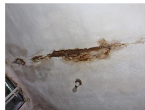
FIGURA 12 - Oxidação da estrutura (lajes superiores) | Fonte: Dados produzidos pelo autor (2021)
