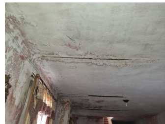
FIGURA 9 - Infiltração no Castelo pela laje superior (terraço) | Fonte: Dados produzidos pelo autor (2021)
