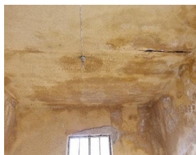
FIGURA 11 - Infiltração no Castelo por toda laje de cobertura | Fonte: Dados produzidos pelo autor (2021)
